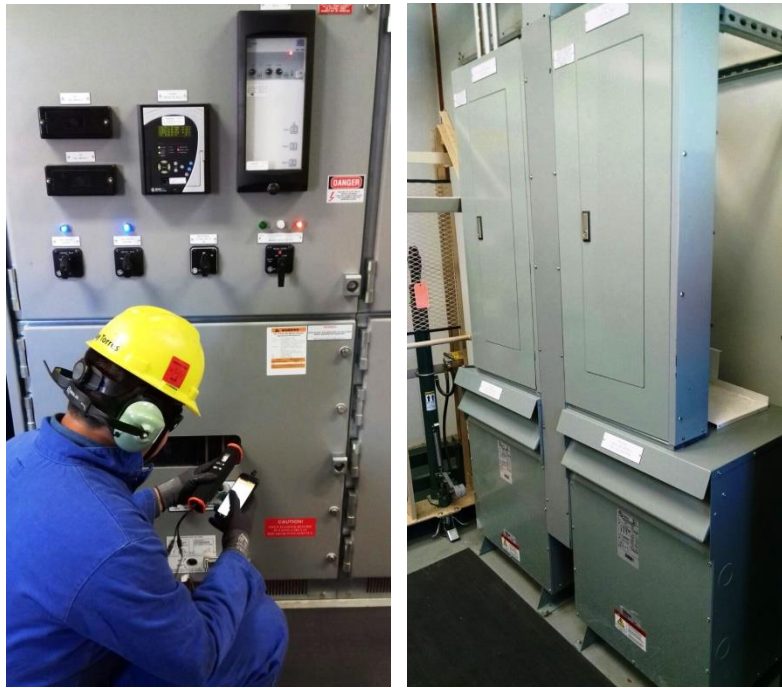
FIGURA 6: LA TECNOLOGIA DE ULTRASONIDO ACUSTICO ES CAPAZ DE DETECTAR, GRABAR Y DIAGNOSTICAR FALLAS DE COMPONENTES ELECTRICOS SIN NECESIDAD DE ESTAR EN EXPOSICION DIRECTA CON DICHS COMPONENTES
