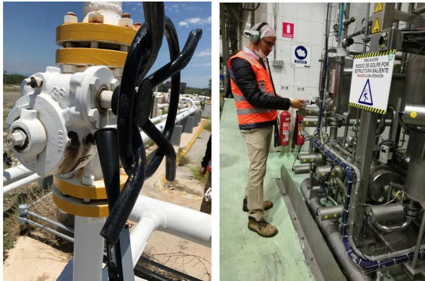
FIGURA 4: EL DETECTOR UL101 INSTRINSECAMENTE SEGURO ES CAPAZ DE DETECTAR FUGAS DE GASES INFLAMABLES COMO EL METANO O GASES QUE PUEDEN CAUSAR ASFIXIA COMO EL CO2, DANDOLE VERSATILIDAD AL TECNICO QUE LO UTILIZA
