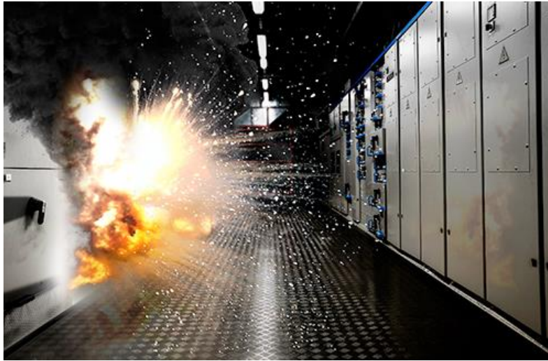
FIGURA 5: YA SEA POR UNA DESCARGA ELECTRICO O POR LA EXPLOSION DEL ARCO ELECTRICO, LAS HERIDAS CAUSADAS POR LA ELECTRICIDAD SON CRITICAS Y DE LAS QUE MAS FACILMENTE SE CONVIERTEN EN FATALIDADES
