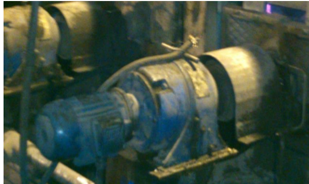
Fig. 1.8 Cada manguera de ½" completamente abierta a una presión de 100 PSI equivale a 100 HP (74.6 Kw-Hr) de consumo en los compresores de la planta. En Ternium México fueron encontradas múltiples malas prácticas como la que se aprecia en esta imagen
