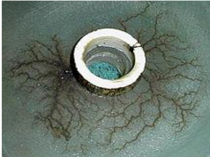
FIGURA 5: LA ARBORESCENCIA ELECTRICA ES UNA CARACTERISTICA DEL FENOMENO TRACKING
