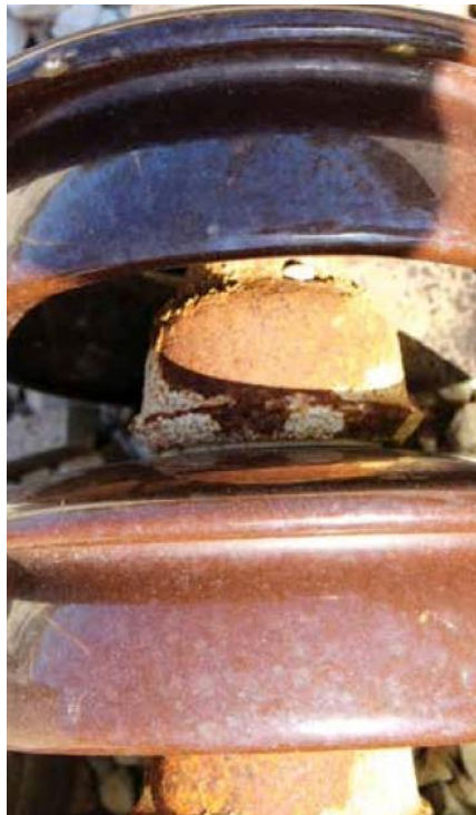
FIGURA 2: AISLADOR AFECTADO POR LA CORROSION GENERADA POR UNA ATMOSFERA IONIZADA
