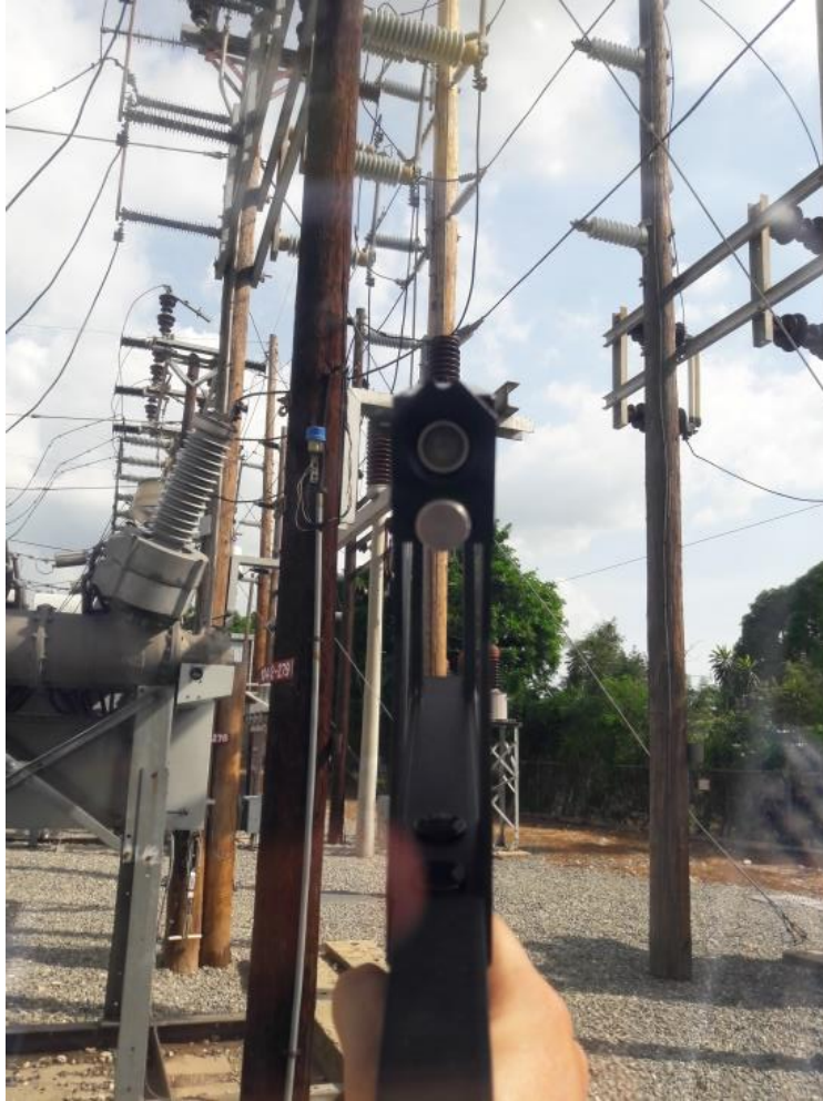
FIGURA 11: VISTA A TRAVES DEL DISCO PARABOLICO DEL POWER BEAM 300 QUIEN CON SU MIRA TIPO RIFLE Y SU PUNTERO LASER AYUDA AL INSPECTOR A LOCALIZAR EL SITIO EXACTO DE LA FALLA DETECTADA
