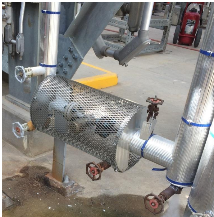
FIGURA 2: LAS TRAMPAS DE VAPOR SON FUNDAMENTALES PARA UNA OPERACION CONFIABLE DE LOS SISTEMAS DE VAPOR, PREVIENIENDO PERDIDAS DE ENERGIA, ANEGACION DEL SISTEMA Y GOLPES DE ARIETE
