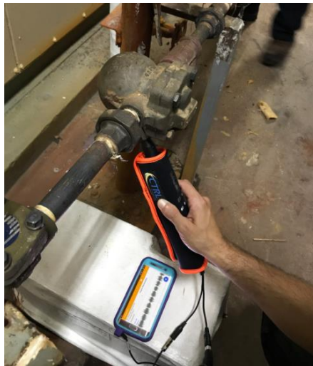
FIGURA 1: EL INSTRUMENTO UL101 EN CONJUNTO CON LA PLATAFORMA INCTRL PROVEE AL INSPECTOR LA CAPACIDAD DE VER EN TIEMPO REAL UNA REPRESENTACION GRAFICA DEL COMPORTAMIENTO DE CADA TIPO DE TRAMPA DE VAPOR
