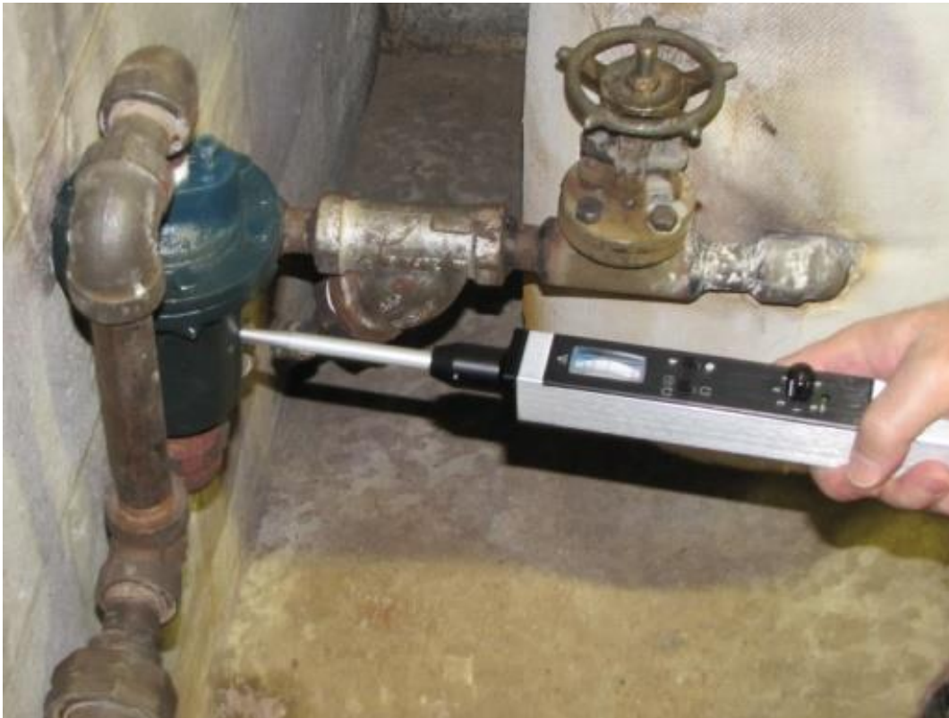
FIGURA 5: DEBIDO A LA DIRECCIONALIDAD DEL ULTRASONIDO AL TOCAR EL CUERPO DE LA TRAMPA DE VAPOR DE CUBETA INVERTIDA EL INSPECTOR PUEDE DETERMINAR SI LA CAUSA DE LA FALLA FUE DEBIDO A LA CONEXION MECANICA ENTRE LA CUBETA Y LA VALVULA
